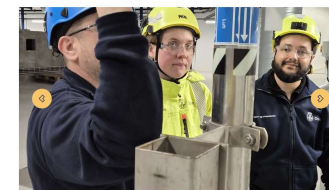
Driftstekniker Arne Drenka kikker på elektrisk kabinett i forbindelse med å teste nytt rengjøringsnitrogen. Det er vanlig vedlikeholdsarbeid på anlegget. Foto: Torm Skjold.
